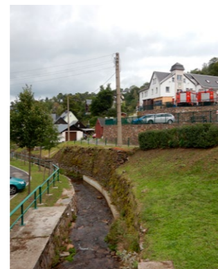
Ansicht der beschädigten Uferstützmauer vor der Sanierung
