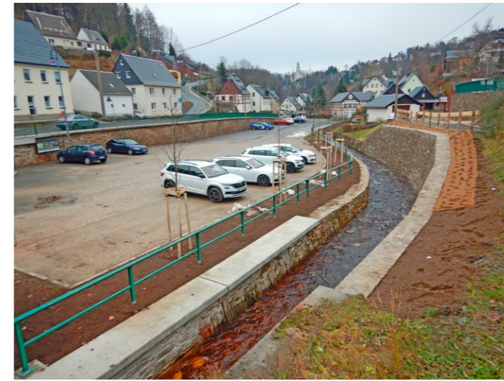
Blick auf das Areal mit der instandgesetzten Uferstützmauer kurz nach Abschluss der Arbeiten
