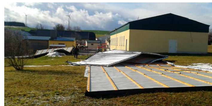
Sturmschaden in Niederlauterstein
